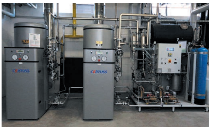
2 x парогенератора CERTUSS Junior 500 SC с блоком снабжения CVE
